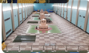
黒部川第四発電所
